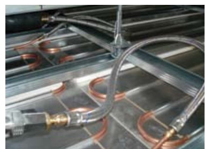
Unterkonstruktion mit den Kühlmäandern und den Schlauchverbindungen zum Rohrleitungsnetz
