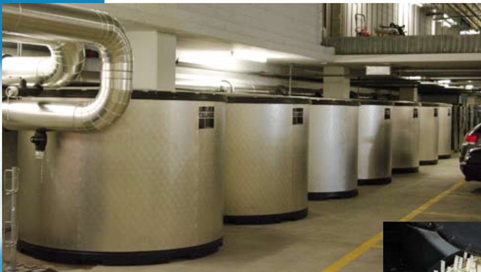
Ein Teil der elf Eisspeicher im Suva-Business-Center, Root.
