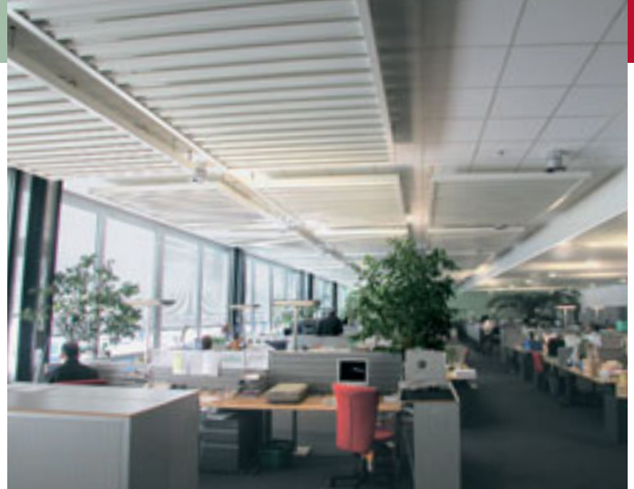
Migros Schönbühl: Kostengünstige Lösung in einem Grossraumbüro: Der Architekt entschied sich für freihängende Kühldecken-segel in einer Rahmenkonstruktion.
