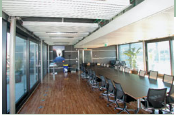
Call Center Orange: Auch im Konferenzraum wurde bewusst eine Kühldecke mit sehr technischem Design und einer akustisch ausgebildeten Raumdecke gewählt.
