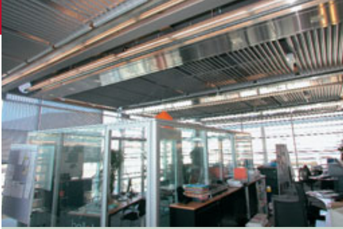
Call Center Orange: Ein hoher Wärme- und Lärmfall vieler PCs und Personen erforderte eine Hochleistungs-Kühldecke sowie die Lösung der Akustik an der Raumdecke.
