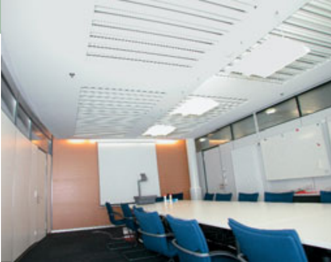
Migros Schönbühl: Das «Oval Office», ein gefangener Besprechungsraum für interne Sitzungen, mit einer konvektiven SKS/4-1-Kühldecke.
