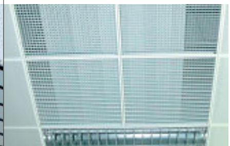
Abb. 3: SKS-4/1 Heiz- und Kühlelemente oberhalb einer offenen Zwischendecke
